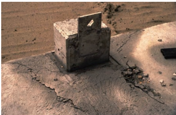
Figuur 3: En ook daar waar het tot geen instortingen komt, is vaak de economische schade groot. Hier een voorbeeld van een prefab betongevelement, waar de oplegnok door het ontbreken van een adequate ophangwapening is bezweken. Ca 13.000m 2 van de gevelementen was reeds gefabriceerd. Alle elementen hadden hetzelfde defect.
