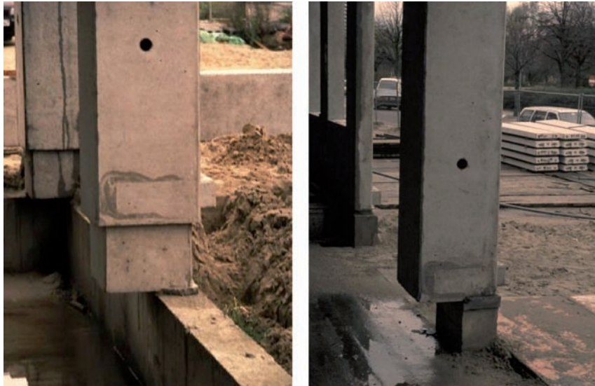
Figuur 5: Ondersteuning van dragende prefab betonkolommen. Resultaat van ontoereikende uitwerking in het ontwerptraject.
